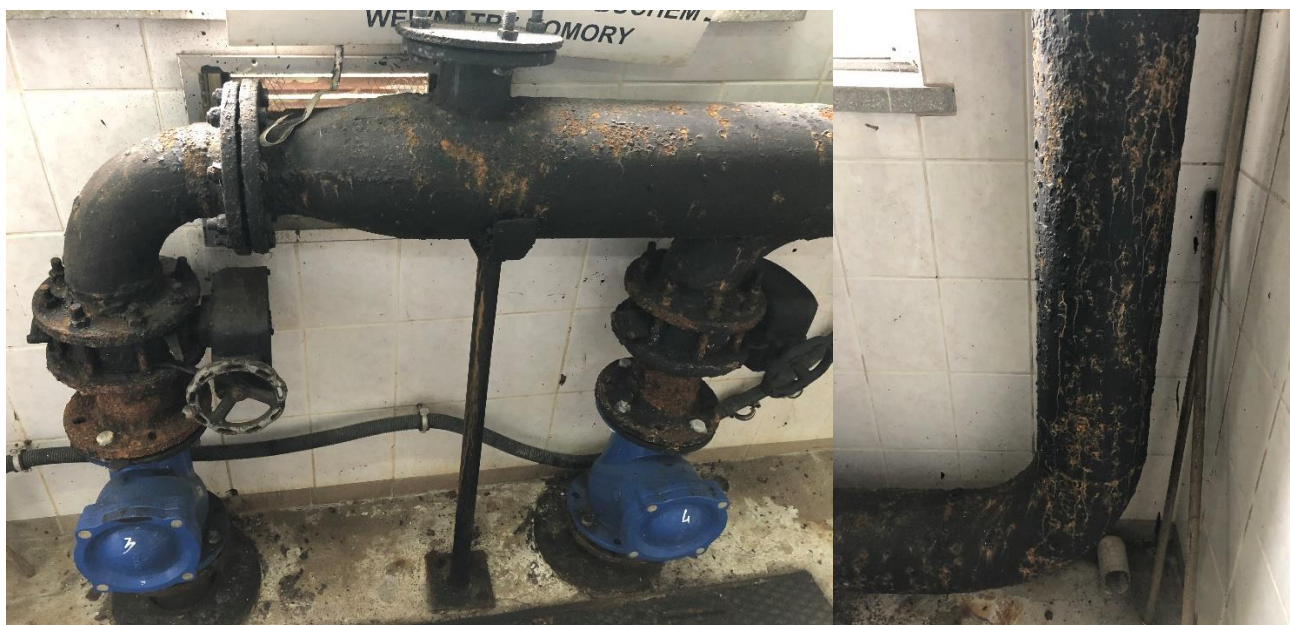
Rysunek 2. Korozji instalacji - na całym obiekcie oczyszczalni
